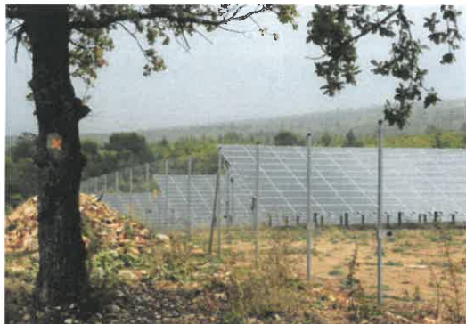
Centrale solaire de Blauvac (84) Photo du site
